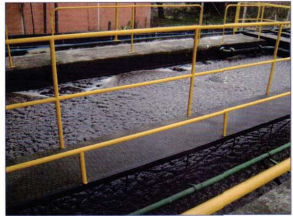
Uma das estações de tratamento operadas pela Fator
